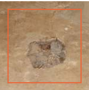
Figura 3: Buraco no piso
